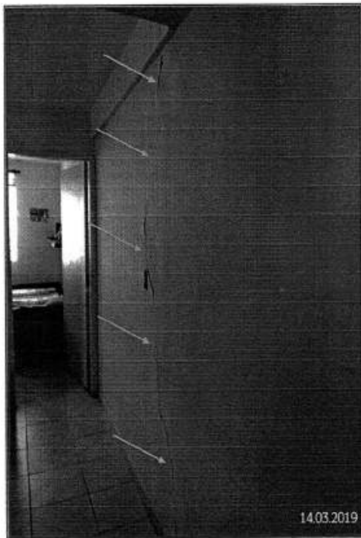
Foto nº 12: Vista do corredor de acesso ao dormitório 02, proveniente da ampliação na área "dantes" descoberta. Detalhe para a trinca na edificação ampliada.
