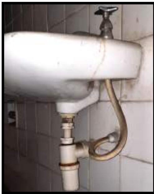
IMAGEM 25- BANHEIRO/ ENCANAMENTO LAVATÓRIO
