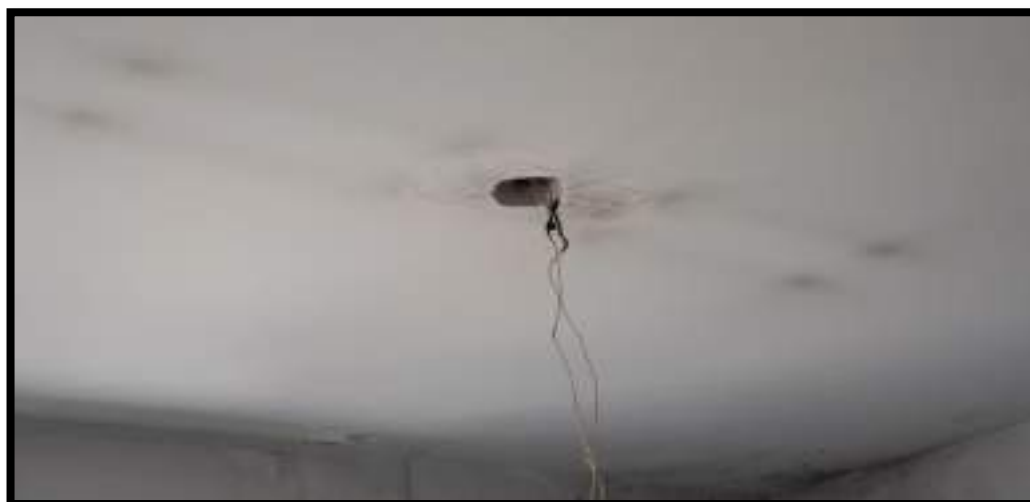
IMAGEM 41- SALA 1 / PONTO DE ILUMINAÇÃO
