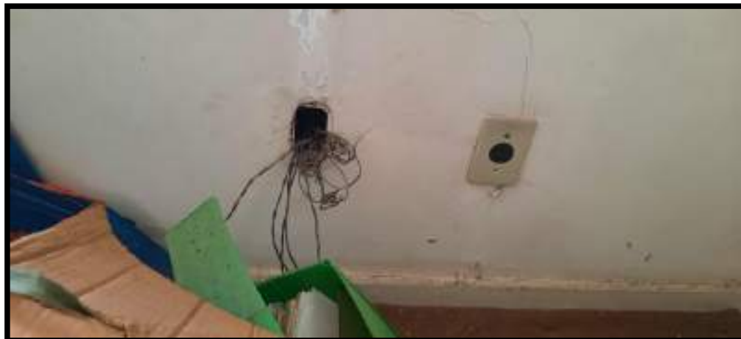
IMAGEM 42- SALA 1 / FIAÇÃO DE PAREDE
