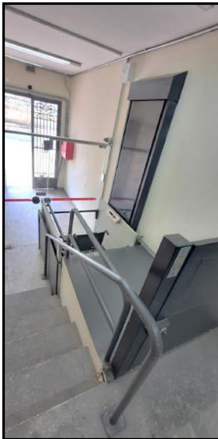
IMAGEM 10- ELEVADOR DE ACESSIBILIDADE
