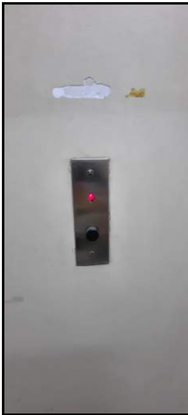
IMAGEM 67- PAINEL DOS ELEVADORES
