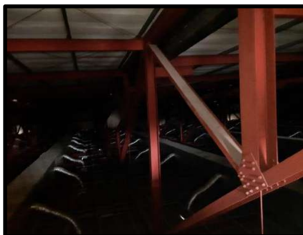
FOTO 41 - VIGAS E SISTEMA DE AR CONDICIONADO
