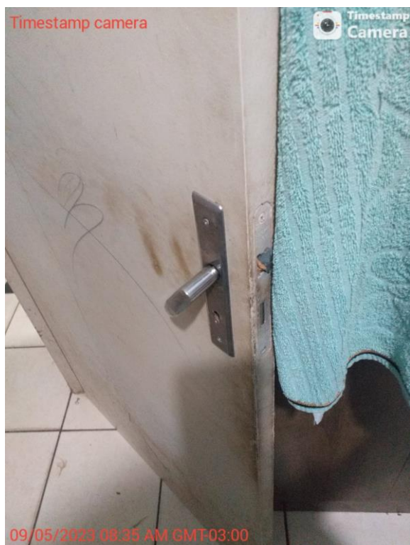
Foto da porta do dormitório da esquerda com a fechadura solta.
